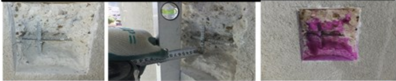
⑤鉄筋の腐食状況を確認
