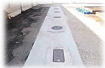
マンホールトイレ
