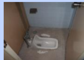
<暗く臭いが残るトイレ>
